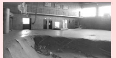
朽ちた床が波打ってしまった浪江町立請戸小学校の体育館
